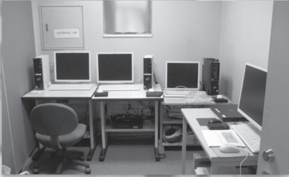
サーバールーム
